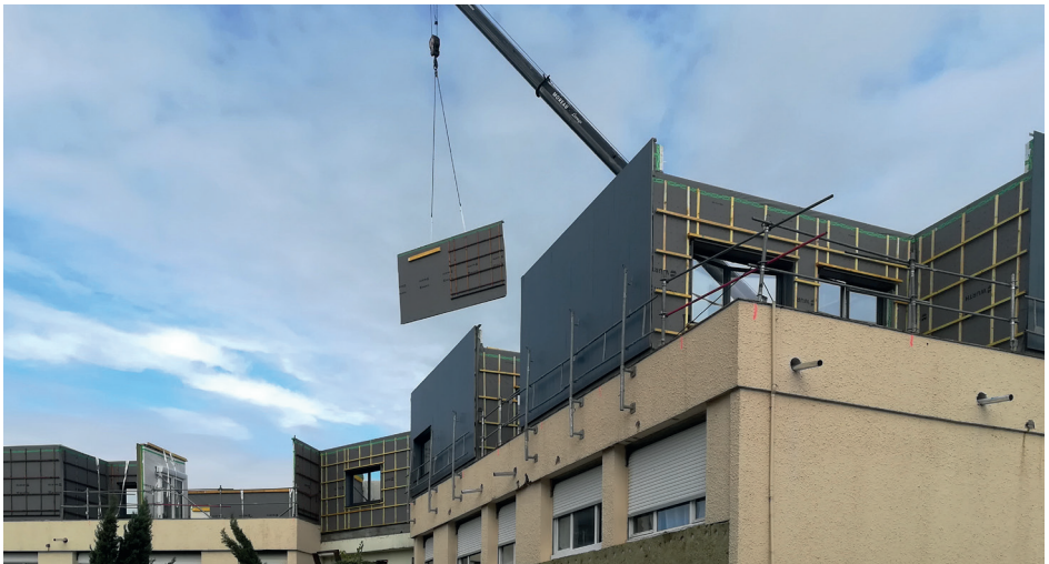
Utilisation de panneaux bois pour la surélévation et la rénovation, filière soutenue par un programme régional expérimental Crédits photo : Gironde Habitat
