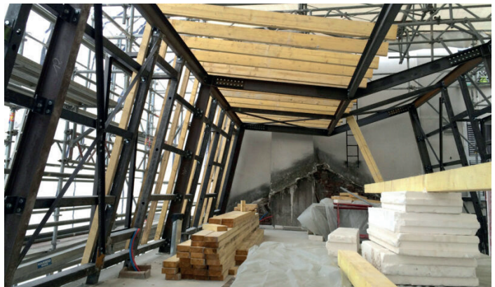
Charpente métal et bois d'un projet de surélévation dans le 14e arrondissement de Paris (Crédits photo : Vazistas)
